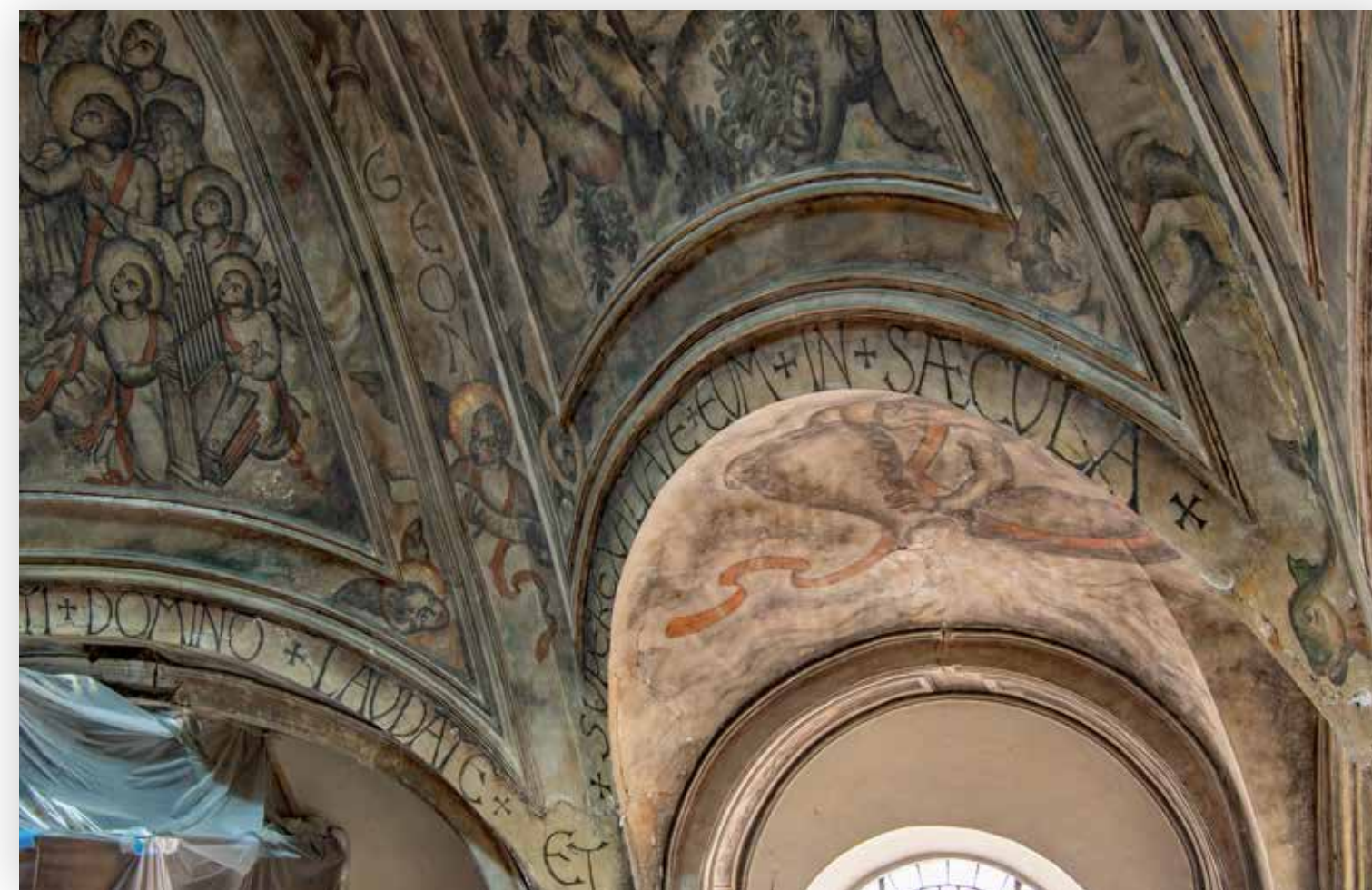
Scheurvorming bij de geboorte van het gewelf.
